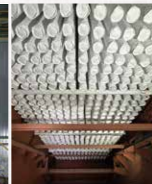
ろ過式集じん器内部
